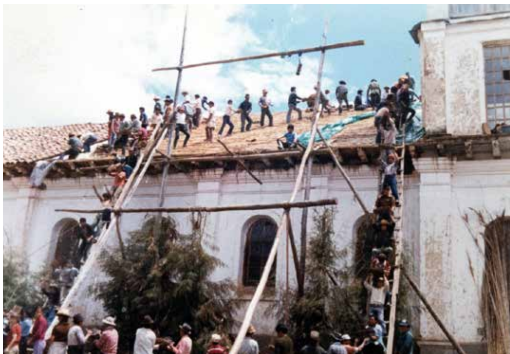
Iglesia de San Pedro de Sayausí. Le habíamos cambiado el techo y era la última minga, ya para terminar. En la cultura de ese pueblo, al terminar el techado se pone una cruz. Y se nombran padrinos. En este caso fuimos Mons. Luis Alberto Luna, arzobispo de Cuenca y mi persona.
